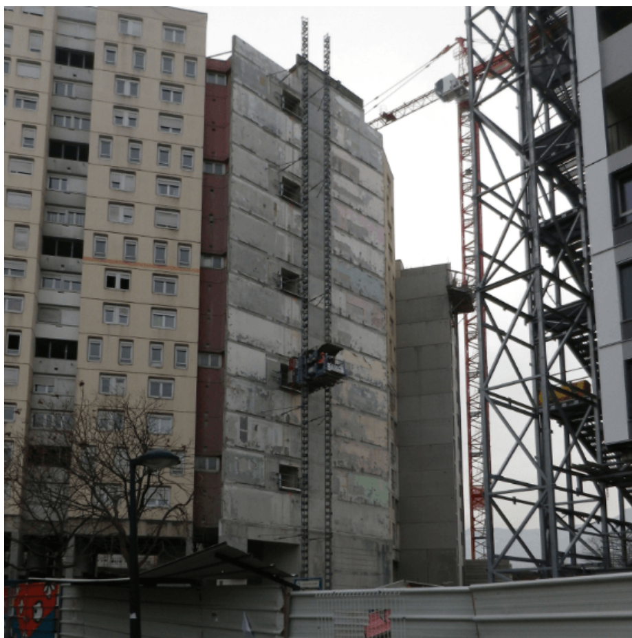
Figure 2 : Photographie des traces de la démolition sur la façade du 50 Arlequin, Villeneuve de Grenoble, le 28 janvier 2016.
